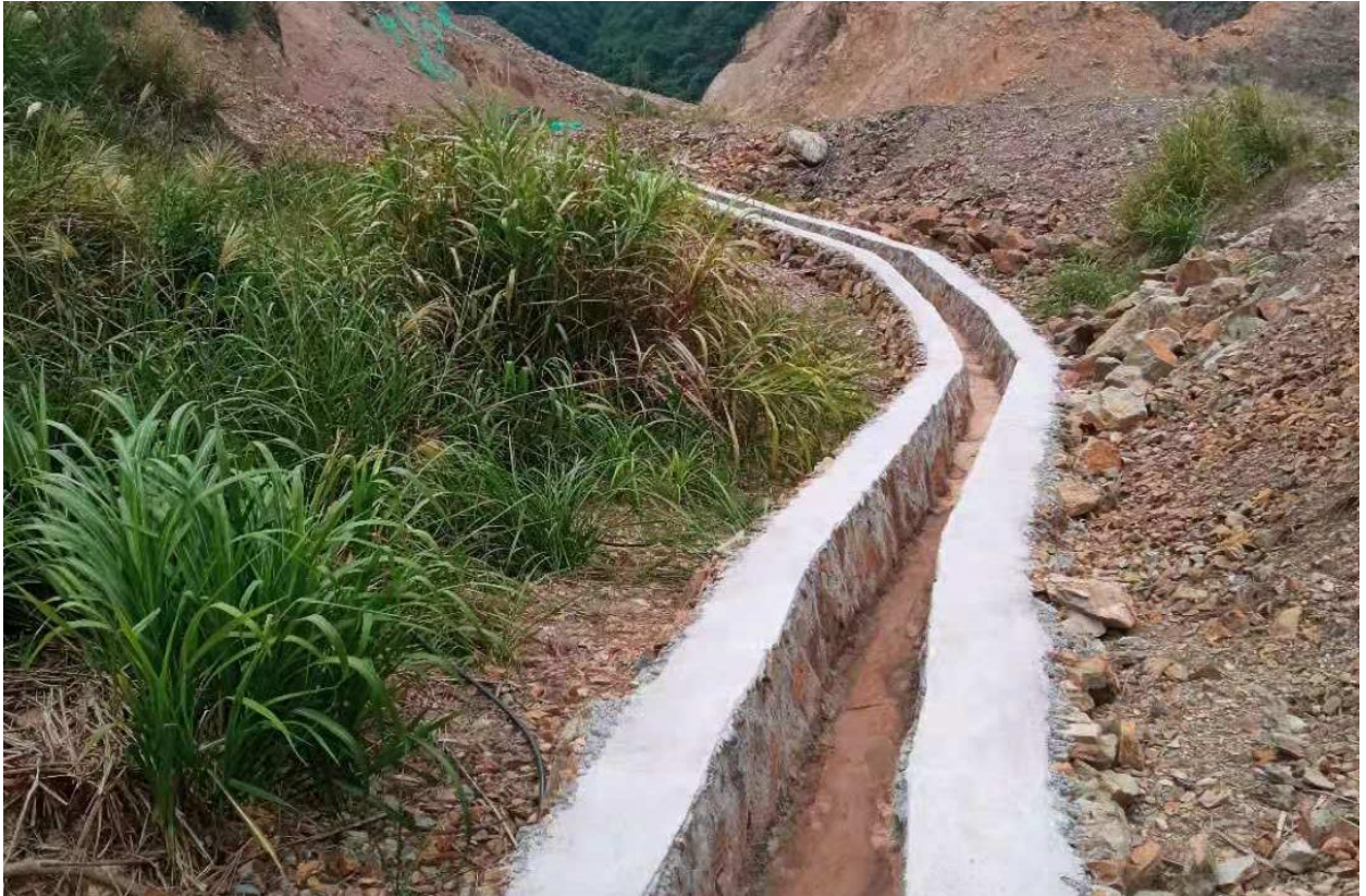
采矿场区排水措施 (2021年8月)
