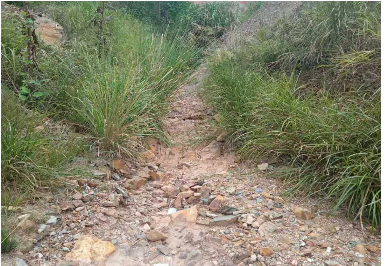
生产生活区排水措施（2021年8月）
