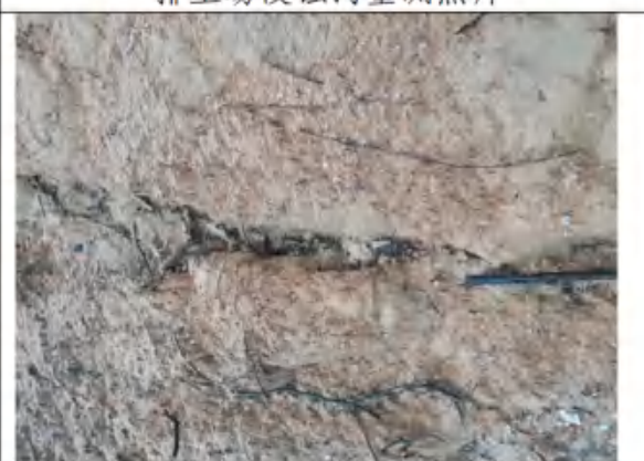
生产生活管理区侵蚀沟量测照片
