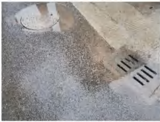
3、雨水口、雨水井
