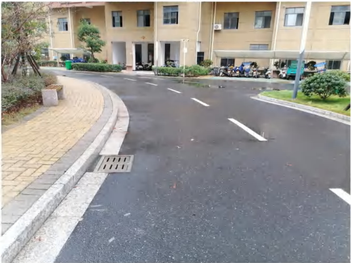
道路广场区排水口（2022年10月）
