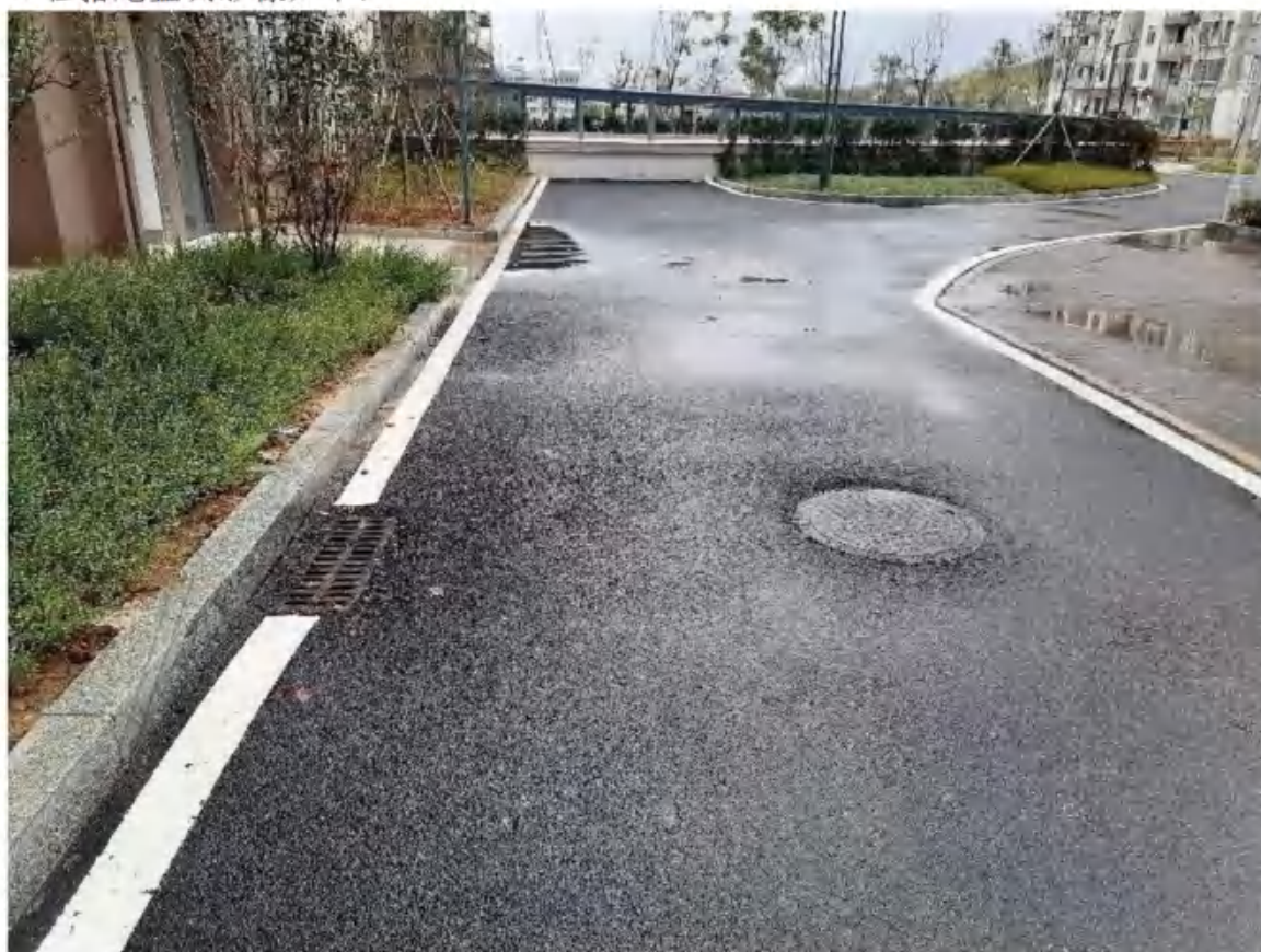
广场道路区雨水口、雨水井（2022年11月）
