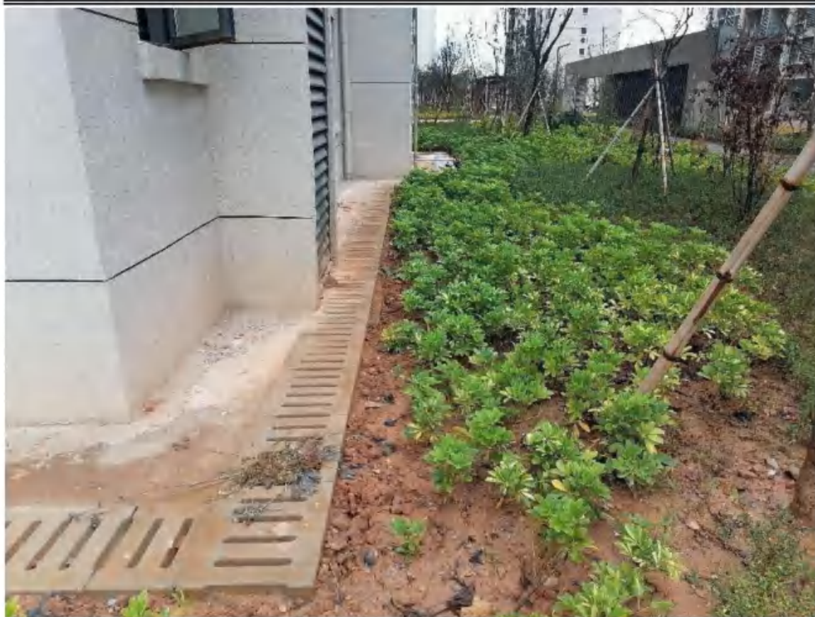
建构筑物区盖板排水沟（2022年11月）
